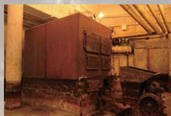
講堂地下室・昭和鉄工製 アサヒボイラS511T
